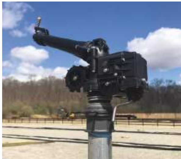
Zainstalowany rotor ST-1200-BR
