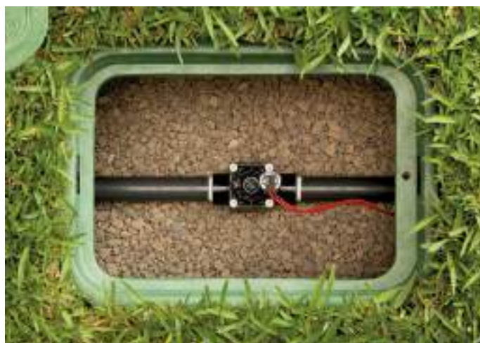
Zainstalowany Zawór PGV-100G
