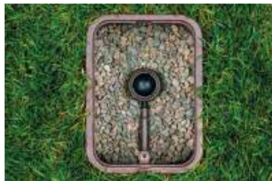
Zamontowany Automatyczny Zawór Płuczący
